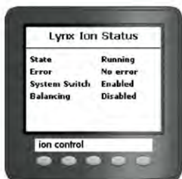
Ion control : Écran d'état du Lynx Ion
